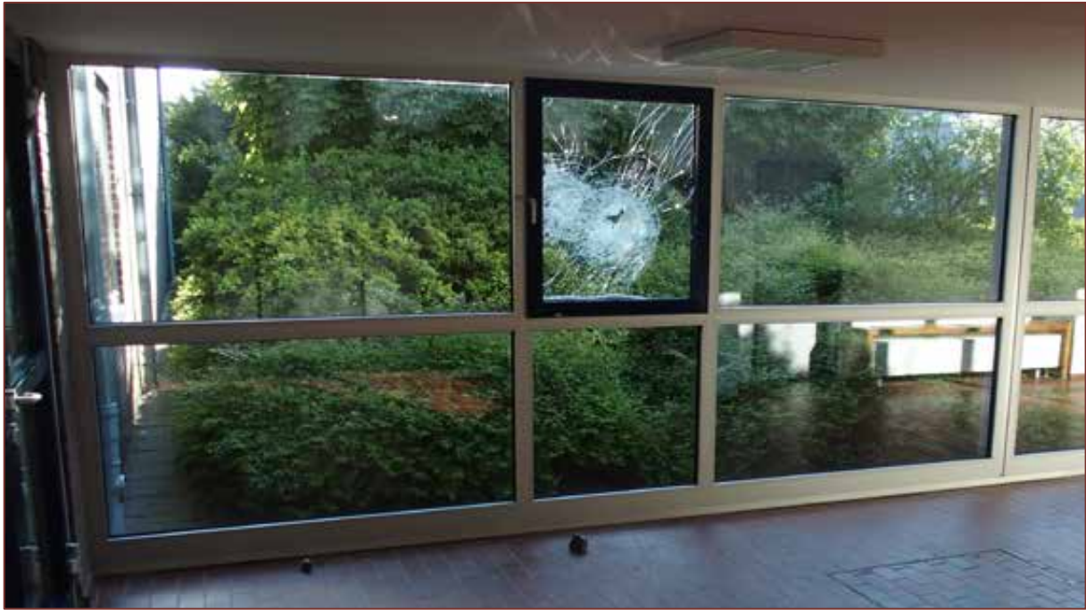
Noch liegt der Stein am Fenster, durch das sich der Einbrecher im Bereich der kleinen Turnhalle Zutritt zur Liebfrauenschule verschaffte.
